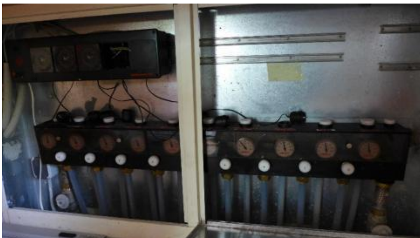
Abbildung 219: Verteilstation der Fußbodenheizung
