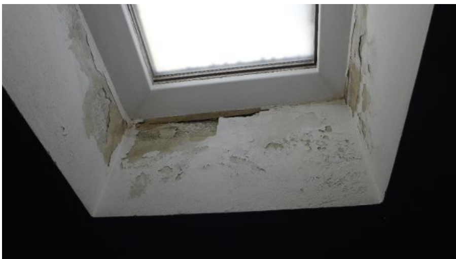
Abbildung 227: Lichtkuppel (Innenansicht) mit Schäden durch Kondensatausfall
