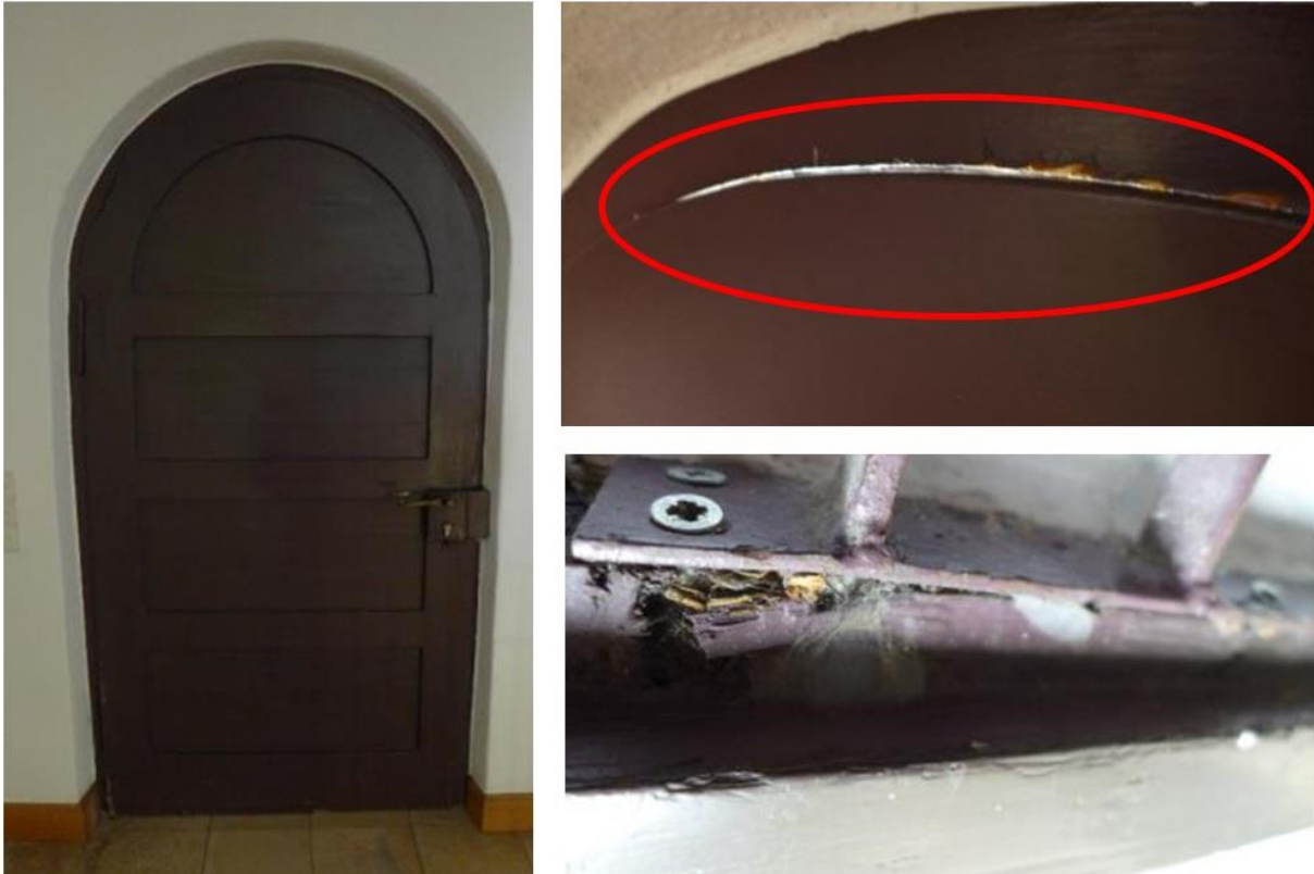
Abbildung 215: Historische Seiteneingangstür EG mit starker Spaltundichtigkeit im oberen Türbogen
