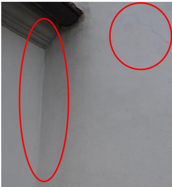
Abbildung 212: Risse im Putz
