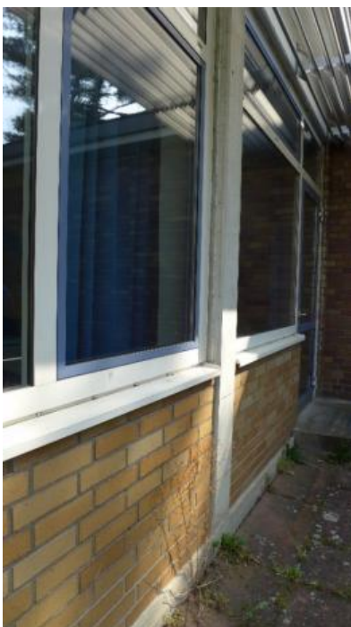
Abbildung 222: Konstruktive Wärmebrücke - Betonständer
