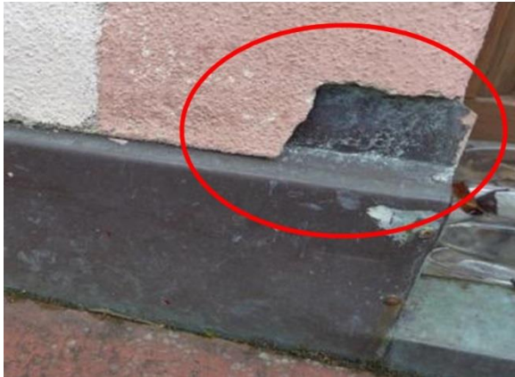
Abbildung 211: Abplatzungen im Terrassenbereich der Burgwehr
