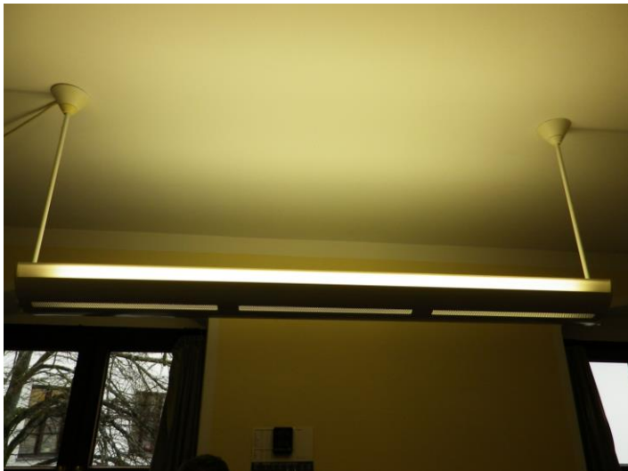
Abbildung 204: Bürobeleuchtung mit Langfeldleuchten
