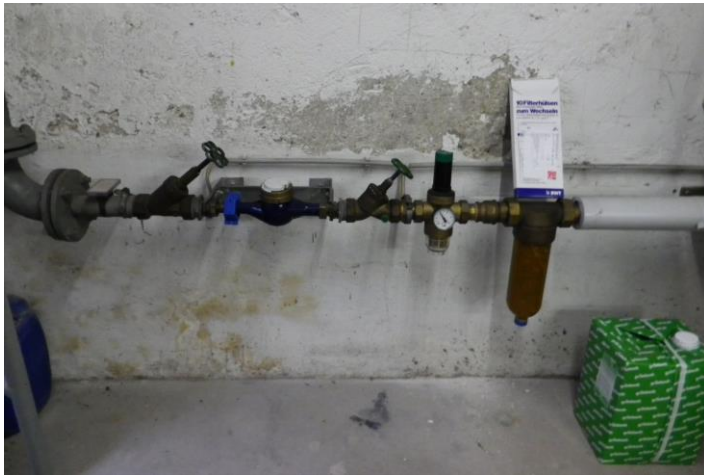
Abbildung 191: Hauptanschluss Trinkwasser mit Filter
